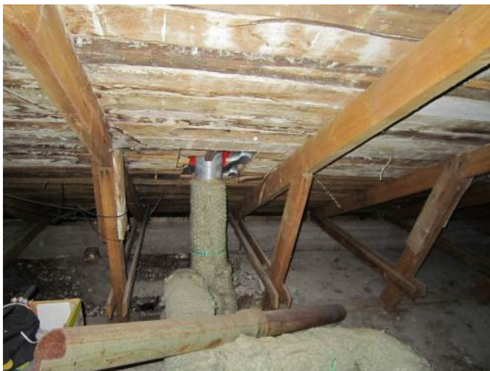
Kuva 22. Ullakolla tuuletusviemäreiden eristystä on lisättävä.
