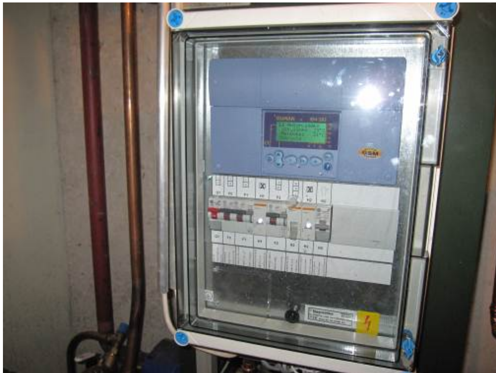
Kuva 41. Lämmönjakohuoneeseen uusittu Ouman EH203- säädin.
