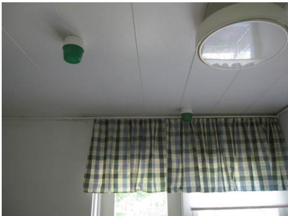
Kuva 36. Poistumistievalaisin. Useita poistumistievalaisimia rikki, kupuja puuttuu ja valaisimia pimeänä.
