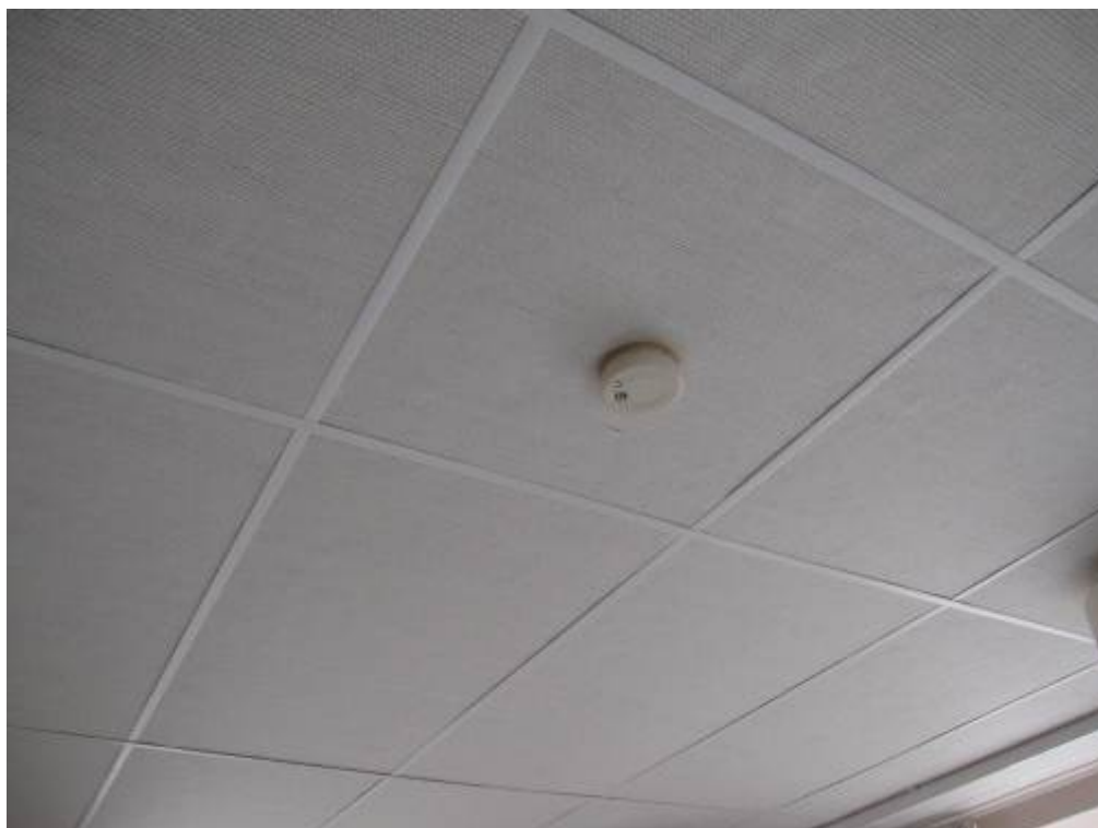
Kuva 31. Rakennuksessa on perinteiset palovaroittimet, ei keskitettyä paloilmoitinjärjestelmää.
