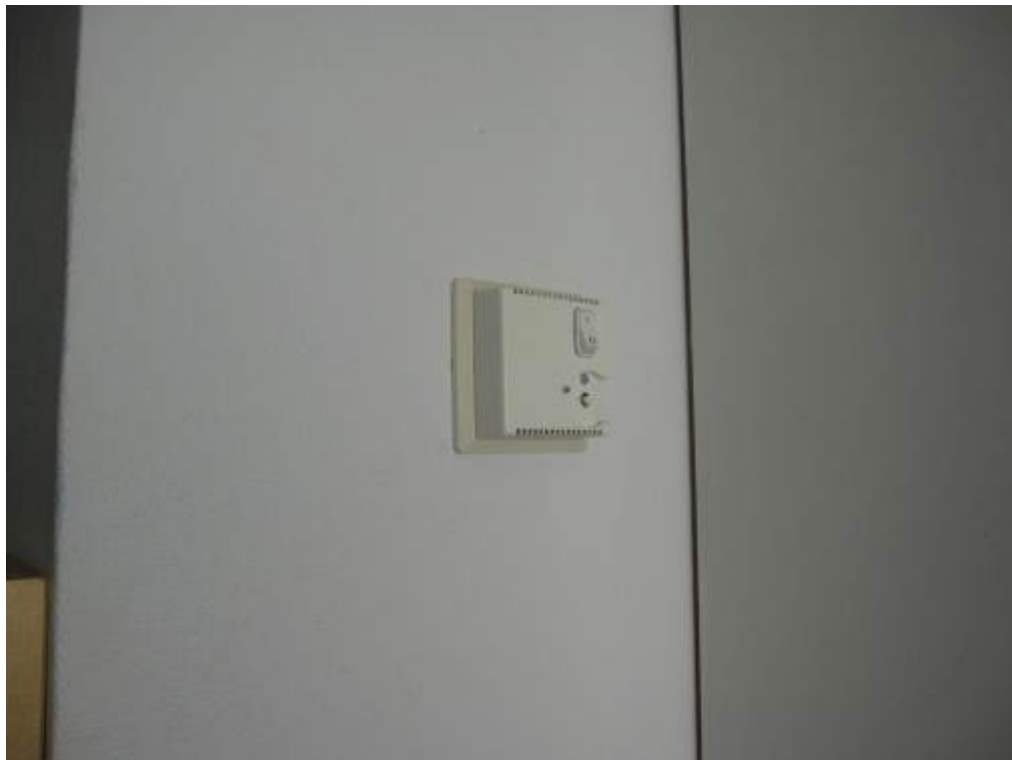
Kuva 35. Lattialämmityksen termostaatin säätönappi puuttuu.
