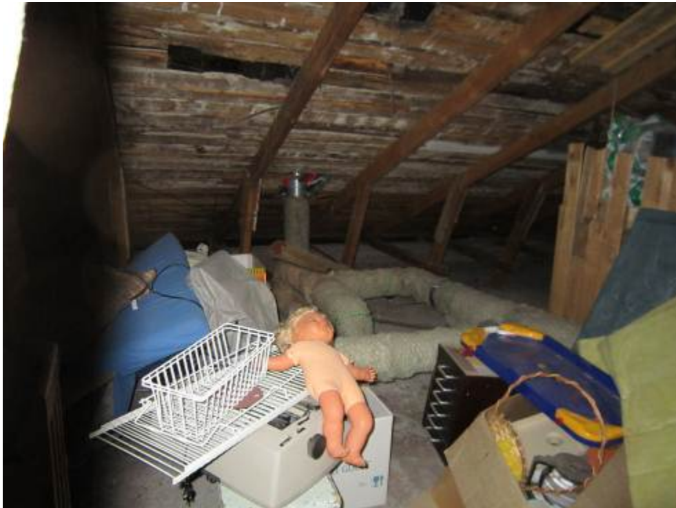
Kuva 13. Rakennuksen ullakolle on varastoitu tavaraa. Tästä aiheutuu tarpeetonta palokuormaa. Tavarat pitää siirtää pois tai hävittää.
