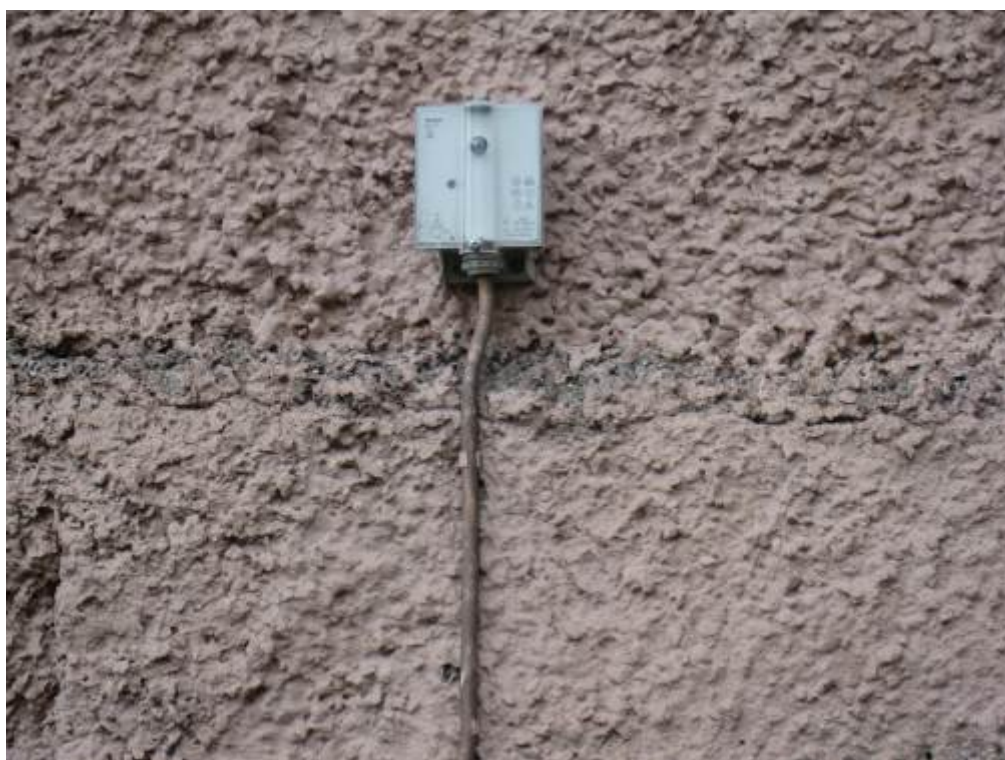
Kuva 40. Ulkovalaistuksen hämäräkytkin ulkoseinällä.
