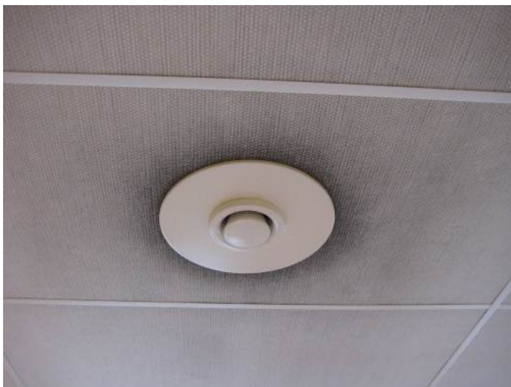
Kuva 24. Tyypillinen poistoilmaventtiili 2-kerroksessa; alle on asennettu suojalevy ilmeisesti peittämään vanhoja jälkiä.
