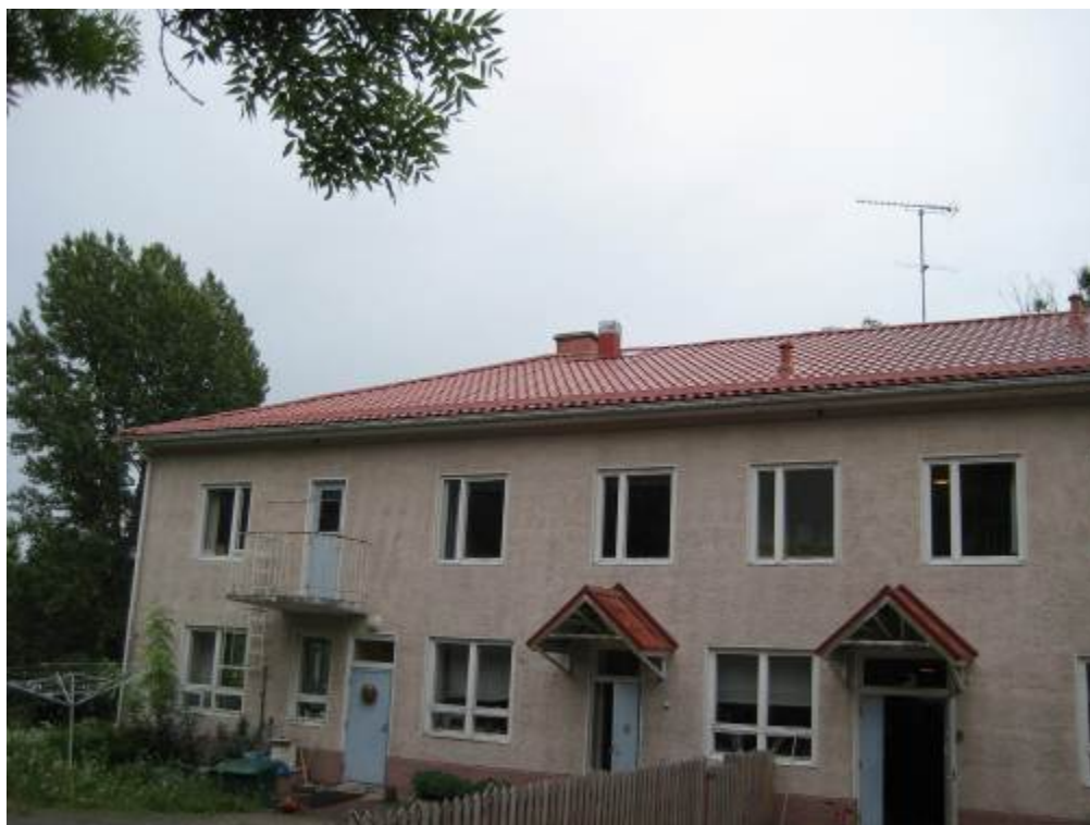
Kuva 23. Vesikatolla olevat huippumurit 2 kpl ovat uusittu hiljattain ja ovat hyvässä kunnossa; vanhat takkaimurit 2 kpl eivät ole enää toiminnassa. Tuuletusviemäri näkyy katon etualalla.
