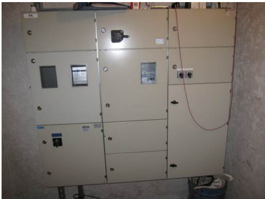
Kuva 30. Sähköpääkeskus on uusittu.
