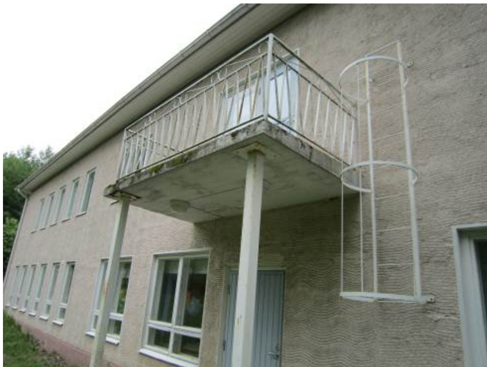
Kuva 6. 1960-luvulla rakennettuun osaan kuuluu pieni, kattamaton parveke. Parveke on erittäin huonokuntoinen.
