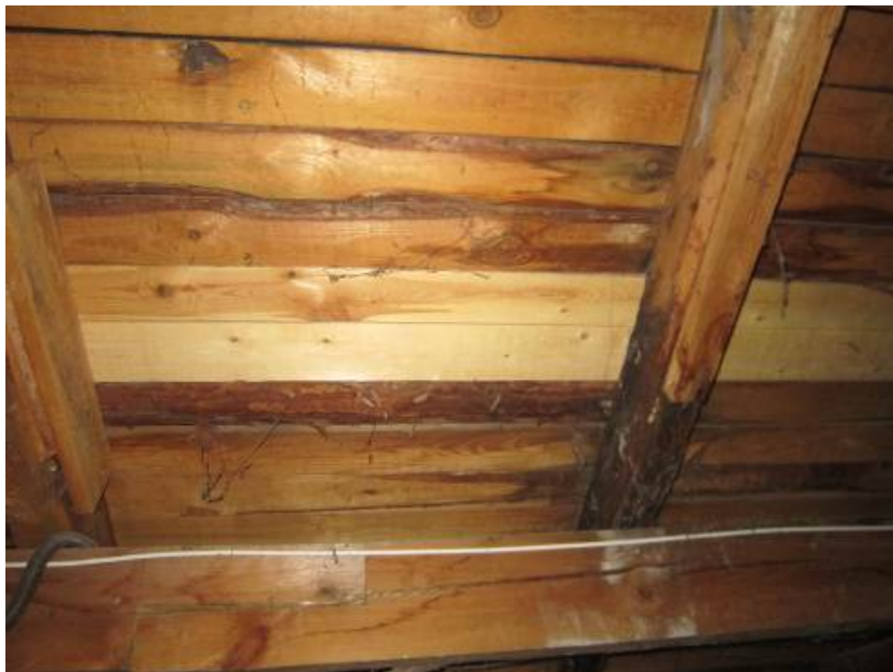
Kuvat 15 ja 16. Vesikaton kantavissa rakenteissa on pahoja kosteus- ja homevauriojälkiä. Jos kastuminen jatkuu, niin jossain vaiheessa rakenteiden kantavuus muuttuu kyseenalaiseksi.
