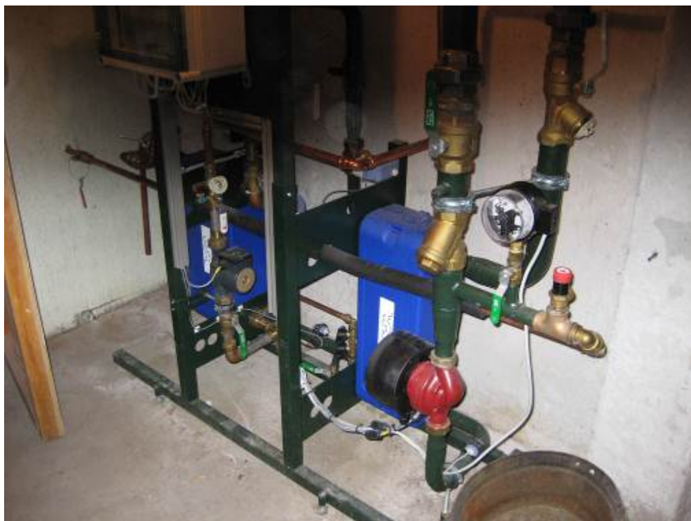
Kuva 18. Kaukolämmön alajakokeskus (Cetetherm, 2007) pohjakerroksen lämmönjakohuoneessa on lähes uusi.
