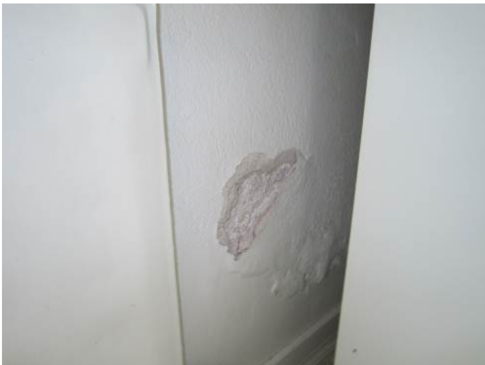
Kuva 14. Kosteusvauriojälkiä 1960-luvulla tehdyn osan ulkoseinässä.
