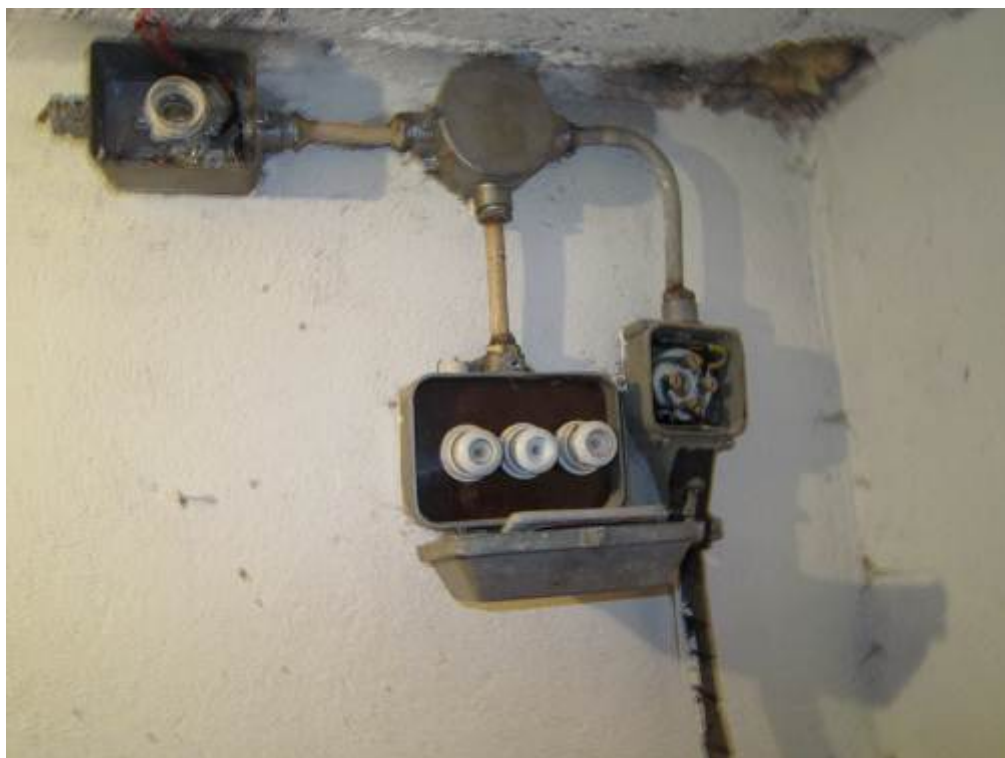
Kuva 39. Kellarikerroksen sähköasennukset tulisi korjata kuntoon.
