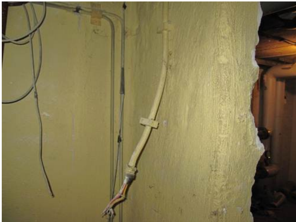
Kuva 37. Sähköasennukset on monin paikoin tehty epäsiististi.
