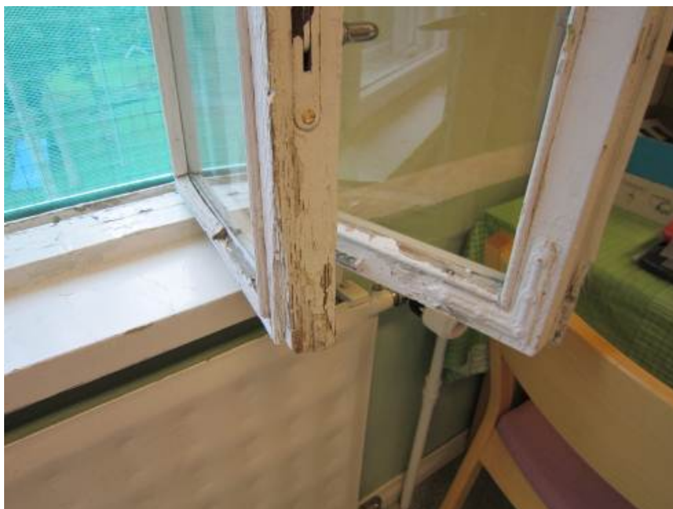
Kuva 12. Rakennuksen ikkunat ovat alkuperäisiä, kaksilasisia, sisäänaukeavia, ikkunoita. ikkunat ovat erittäin huonokuntoisia.
