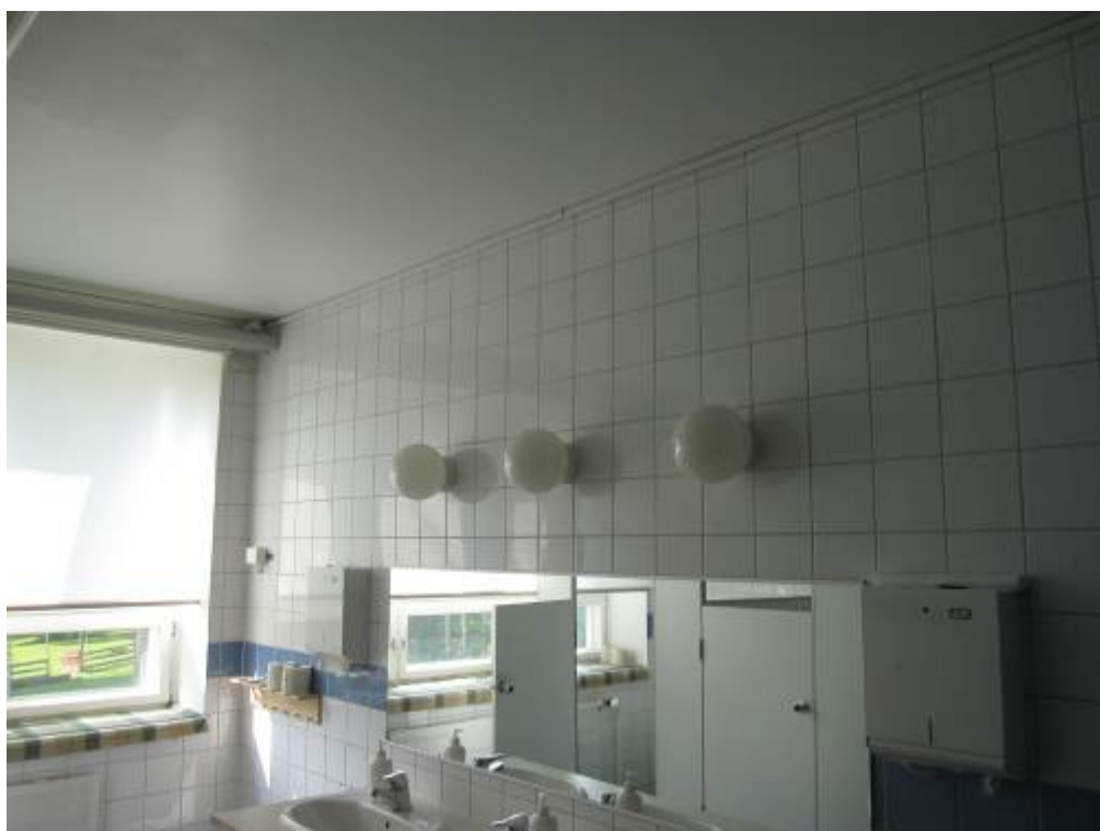
Kuva 34. WC- tiloissa vanhat hehkulamppuvalaisimet.
