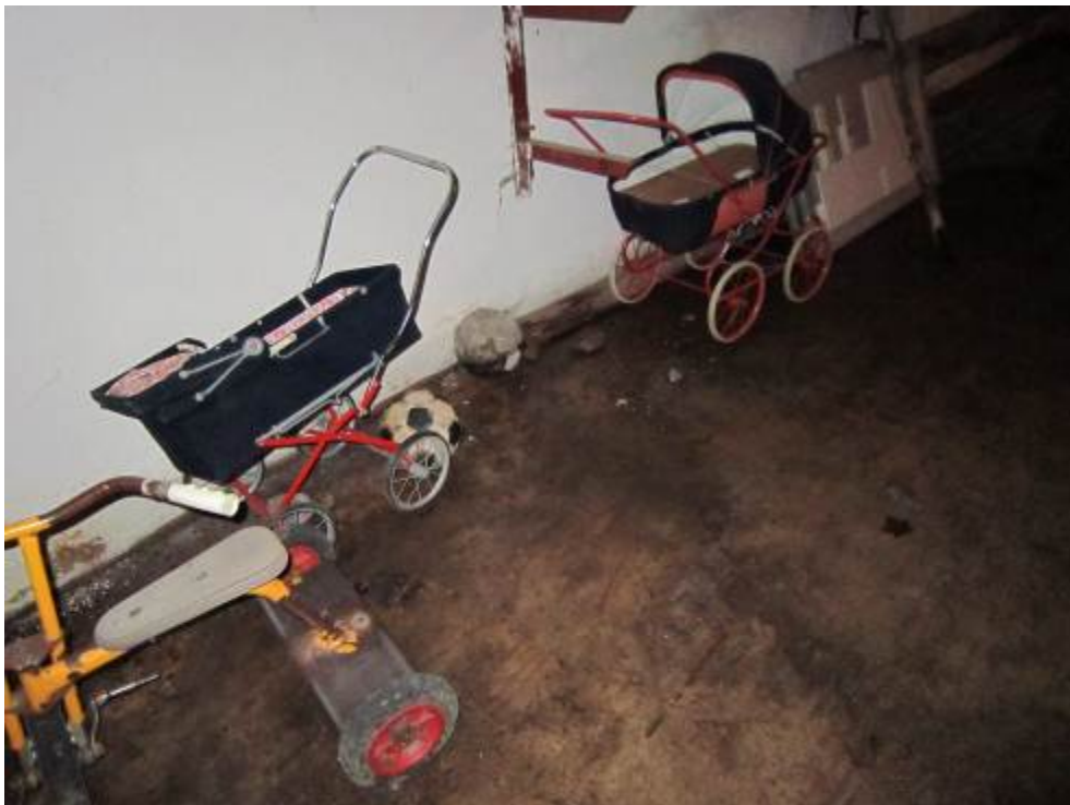
Kuva 10. Autotallin kellarissa säilytetään päiväkodin leikkitarvikkeita. Kellarin lattialla havaittiin kiinteistökierroksen aikana irtovettä. Kellarissa on todennäköisesti mikrobivaurioita. Kellarissa säilytettyjä leluja ei pitäisi siirtää sisätiloihin ennen kuin ne on desinfioitu.
