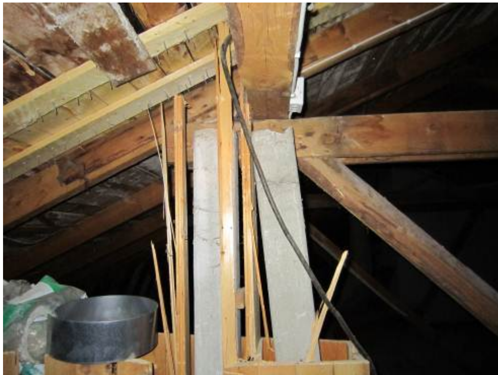
Kuva 17. Vanhaa, puurakenteista ilmanvaihtokotelointia, jonka sisälle on jätetty asbestia sisältävät ilmanvaihtokanavat.
