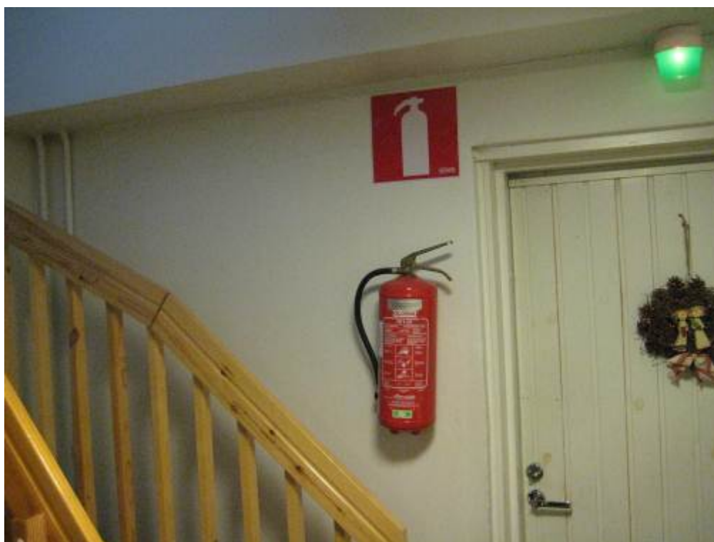
Kuva 26. Rakennuksessa on käsisammuttimia, joiden tarkastukset tehdään kerran vuodessa.
