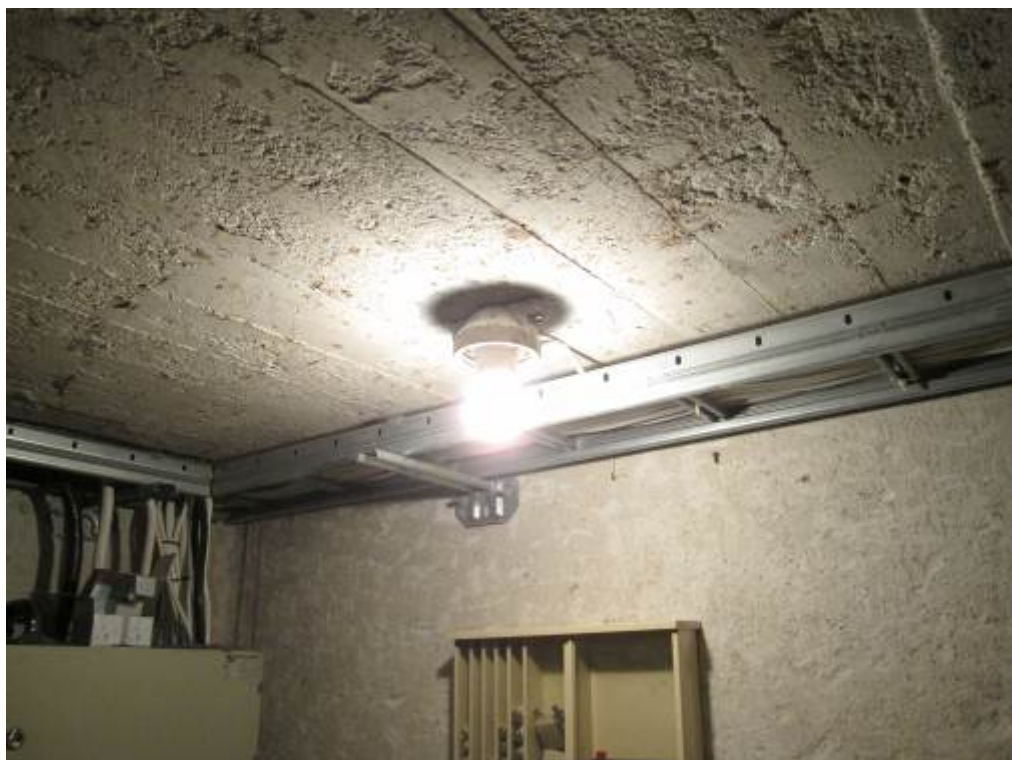
Kuva 38. Useita sisävalaisimien kupuja puuttuu.
