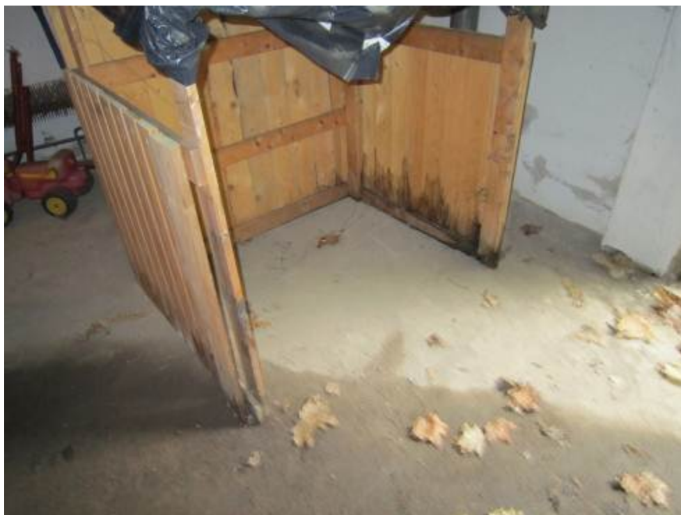
Kuva 11. Pahasti kosteus- ja homevaurioitunut leikkivaruste.
